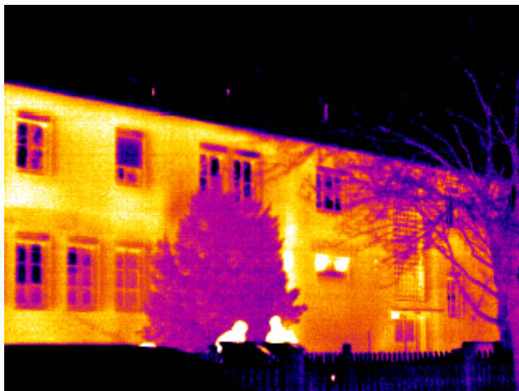
Abb. 14: Westansicht, Wärmebrücken im Kellerbereich, Bericht Thermografie EVN AG (2001)
