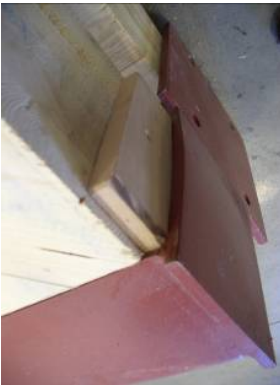
Abbildung 22:Plastifizierung der Stahlplatte Figure 22: Plastification of the steel plate
