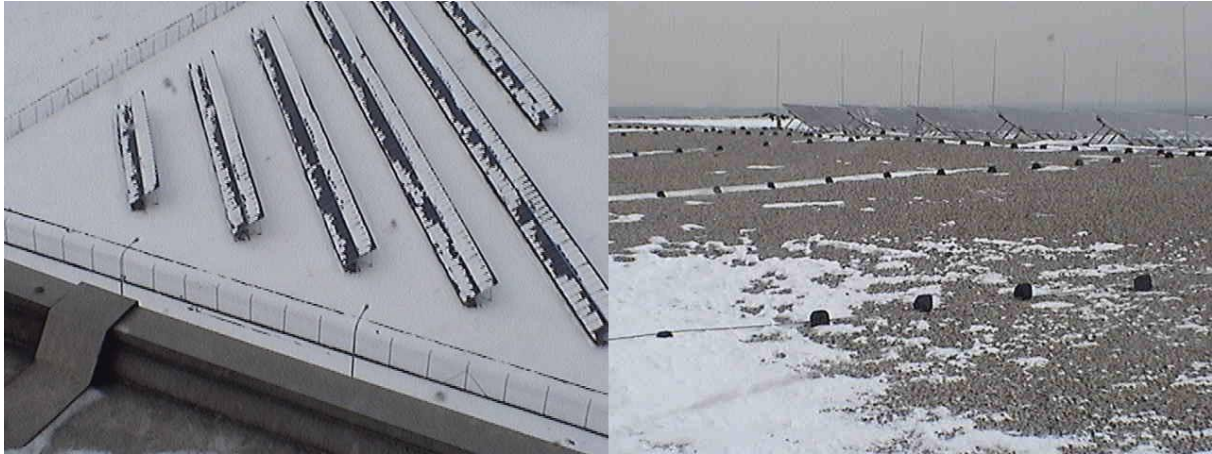
Abbildung 6: Schneebedeckung der Freifeldmodule bei gleichzeitig weitestgehend schneefreien Modulen am Reaktordach am 13.02.2012 um 11:35
