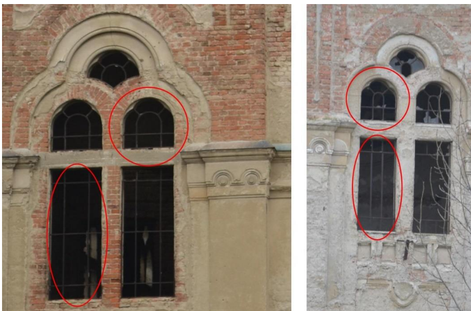
Abb. 44 - Unterschiede zwischen Westfenster (links) und Ostfenster (rechts)
