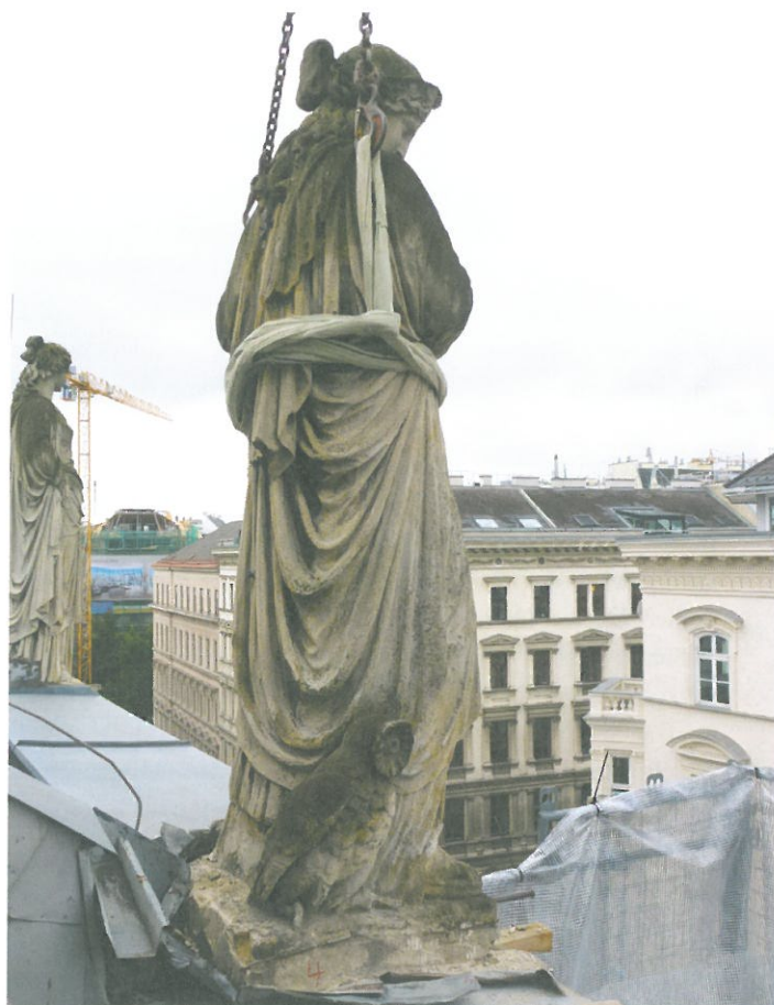
Die Attikafiguren zeigen starke Verwitterungsspuren und müssen umfassend renoviert werden (Foto: ÖIAV)
